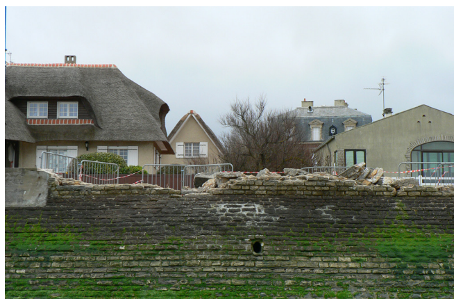
Tempête au poste de secours d'Asnelles (2013)
