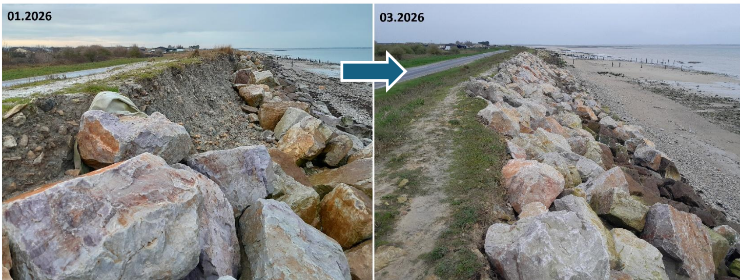
Reprise de tassement d'enrochements (Grandcamp-Maisy)
